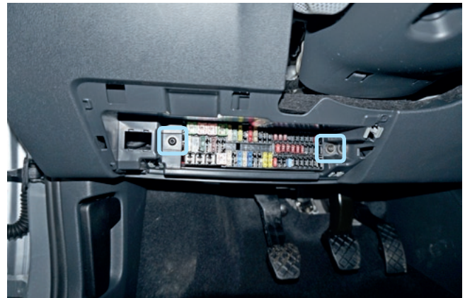
Фото 1.13. Винты крепления блока предохранителей
