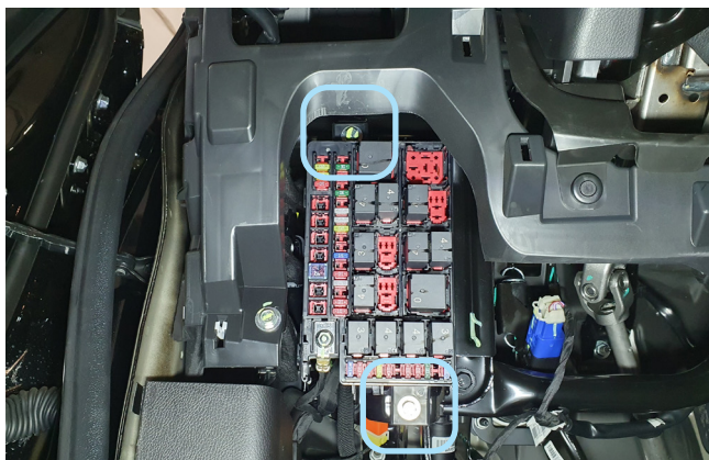
Фото 1.5. Болты крепления монтажного блока предохранителей
