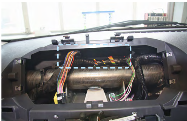
Фото 2.9. Пример расположения центрального блока охранно-телематического комплекса
