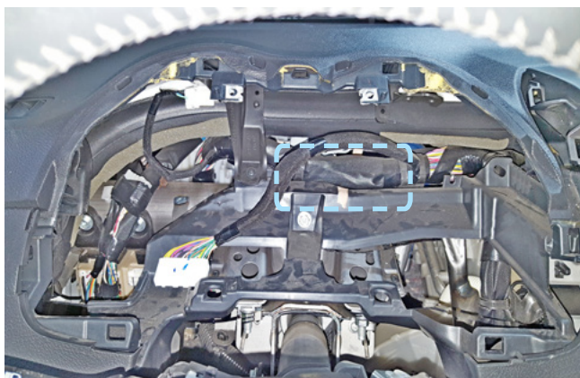
Фото 2.7. Пример расположения центрального блока охранно-телематического комплекса
