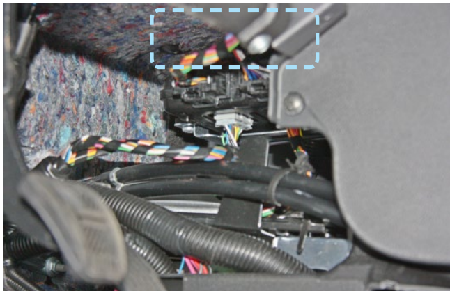
Фото 2.7. Пример расположения центрального блока охранно-телематического комплекса
