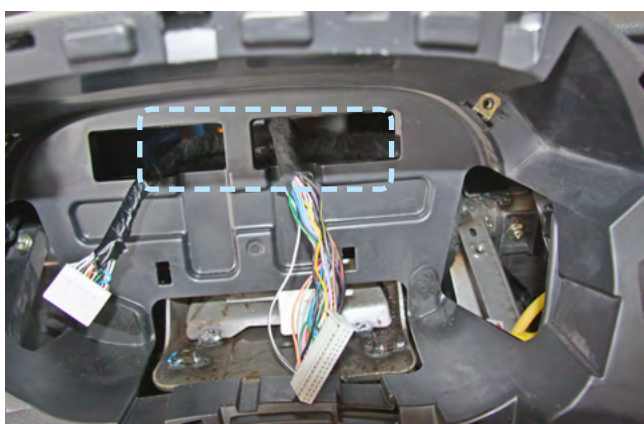
Фото 2.8. Пример расположения центрального блока охранно-телематического комплекса
