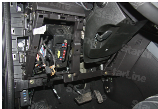
Фото 1.10. Пластиковая накладка снята
