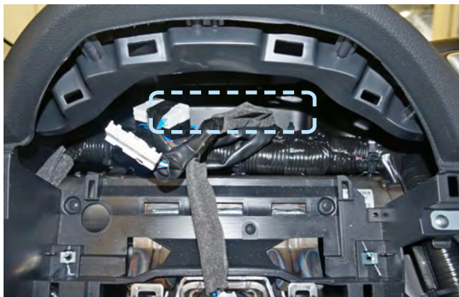
Фото 2.13. Пример расположения центрального блока охранно-телематического комплекса
