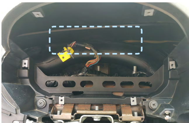
Фото 2.8. Пример расположения центрального блока охранно-телематического комплекса
