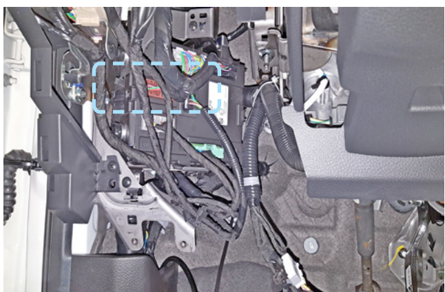
Фото 2.10. Пример расположения центрального блока охранно-телематического комплекса
