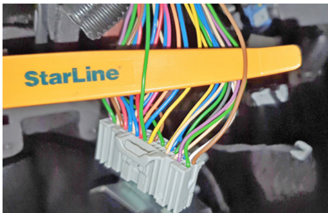
Фото 3.6. Управление центральным замком (зелёный и коричневый)
