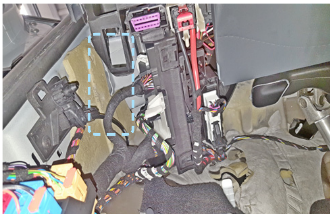
Фото 2.7. Пример расположения центрального блока охранно-телематического комплекса
