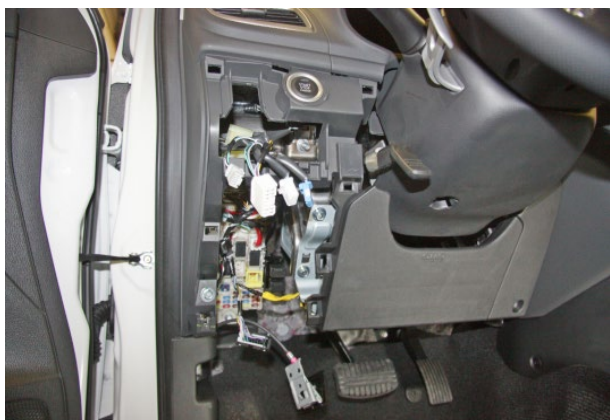
Фото 1.5. Пластиковая накладка снята
