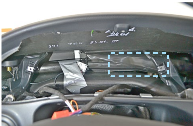
Фото 2.11. Пример расположения центрального блока охранно-телематического комплекса
