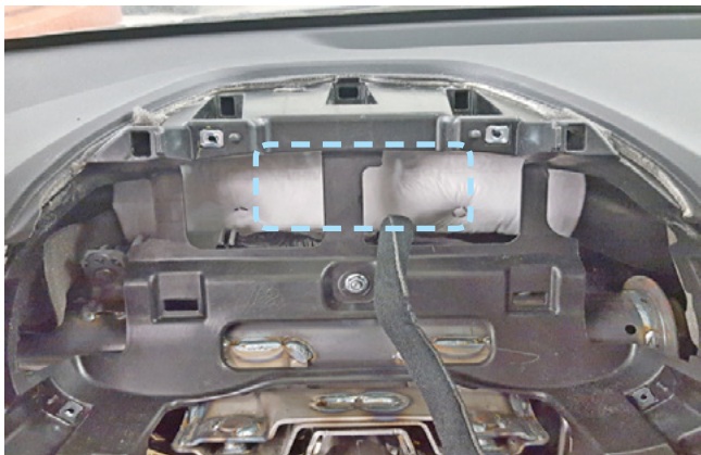
Фото 2.7. Пример расположения центрального блока охранно-телематического комплекса
