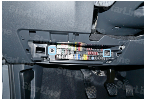
Фото 3.2. Винты крепления блока предохранителей
