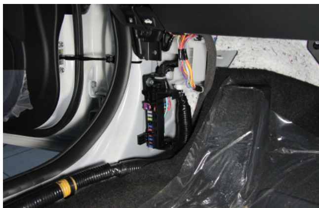
Фото 1.5. Накладка левой кик-панели снята
