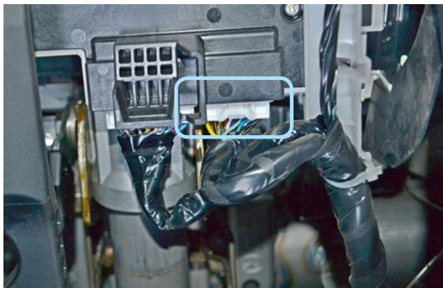
Фото 3.6. Местоположение разъёма блока SSU
