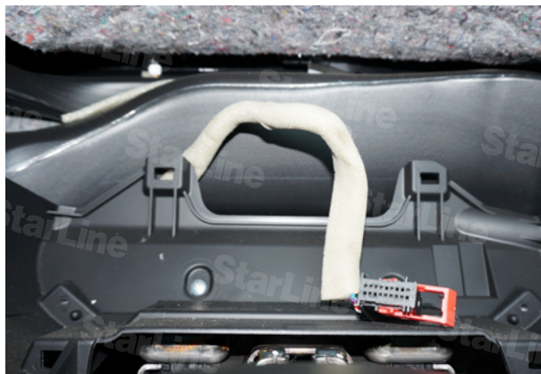
Фото 2.4. Панель приборов снята
