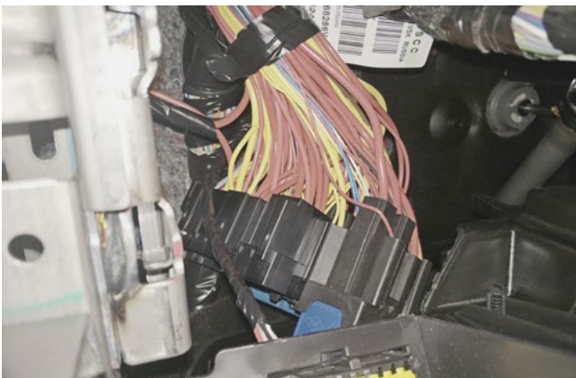
Фото 1.15. Блок предохранителей снят
