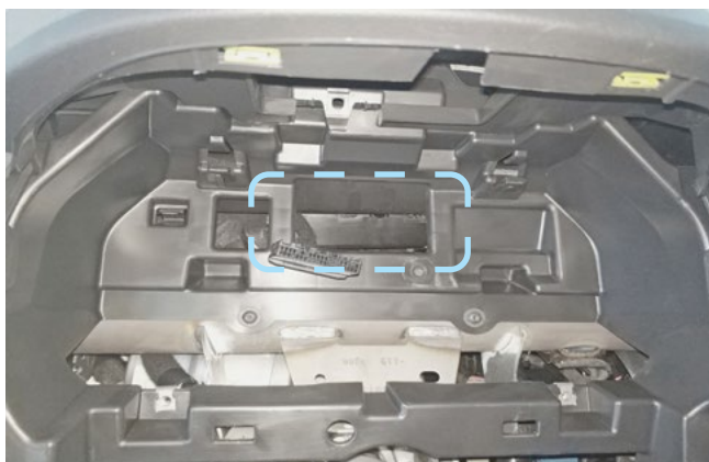
Фото 2.9. Пример расположения центрального блока охранно-телематического комплекса
