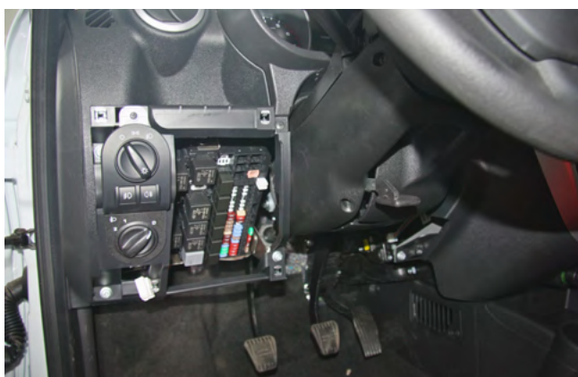
Фото 1.3. Пластиковая накладка снята
