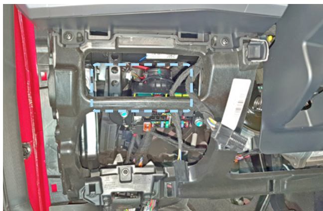
Фото 2.8. Пример расположения центрального блока охранно-телематического комплекса
