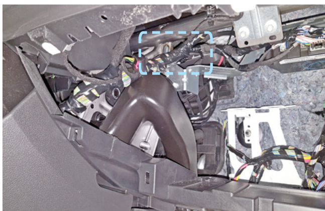
Фото 2.7. Пример расположения центрального блока охранно-телематического комплекса
