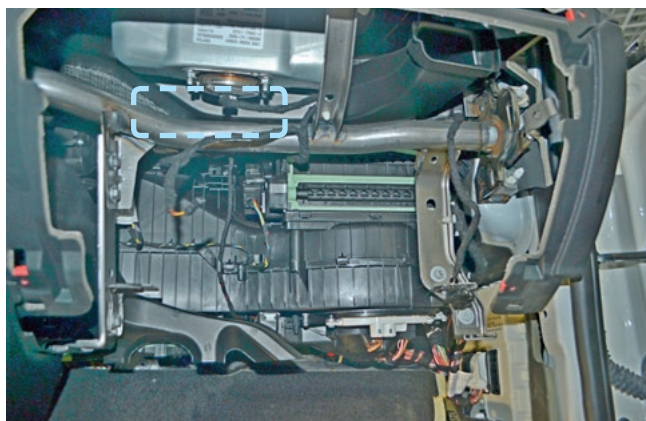
Фото 2.10. Пример расположения центрального блока охранно-телематического комплекса
