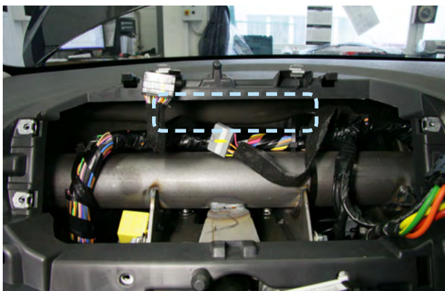
Фото 2.11. Пример расположения центрального блока охранно-телематического комплекса
