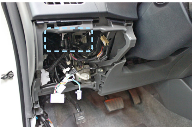
Фото 2.6. Пример расположения центрального блока охранно-телематического комплекса
