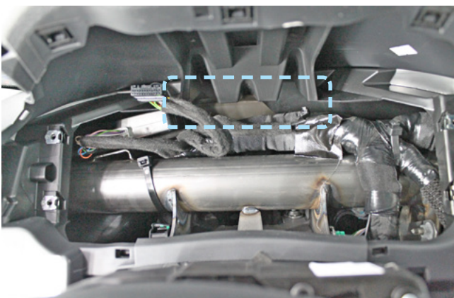
Фото 2.8. Пример расположения центрального блока охранно-телематического комплекса
