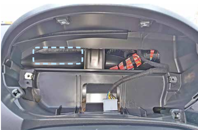
Фото 2.7. Пример расположения центрального блока охранно-телематического комплекса
