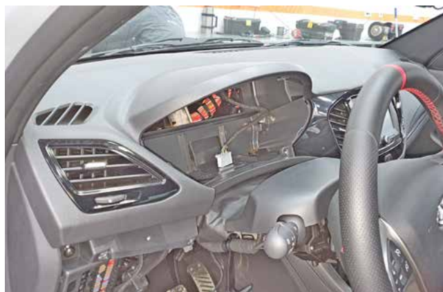
Фото 1.8. Панель приборов снята
