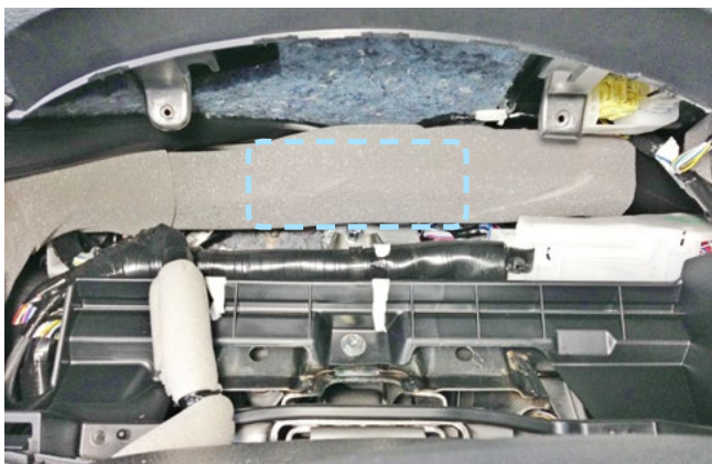
Фото 2.8. Пример расположения центрального блока охранно-телематического комплекса
