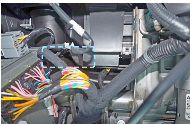
Фото 2.8. Пример расположения центрального блока охранно-телематического комплекса
