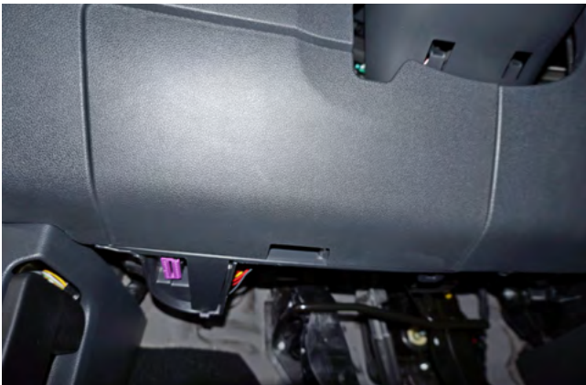
Фото 1.14. Крышка монтажного блока предохранителей
