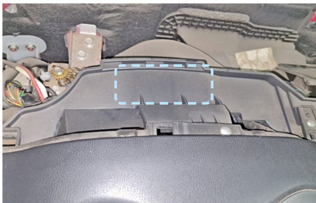
Фото 2.2. Пример расположения центрального блока охранно-телематического комплекса
