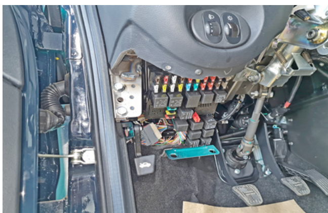
Фото 1.16. Пластиковая накладка снята
