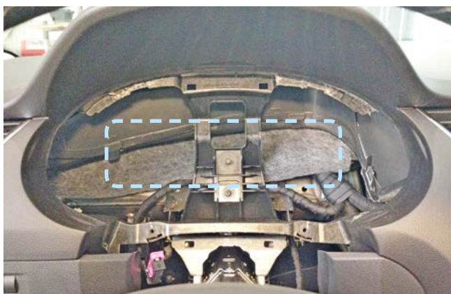
Фото 2.9. Пример расположения центрального блока охранно-телематического комплекса
