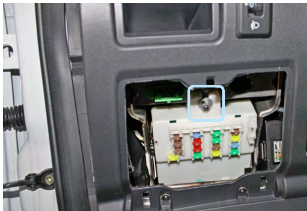
Фото 2.3. Гайка крепления монтажного блока предохранителей
