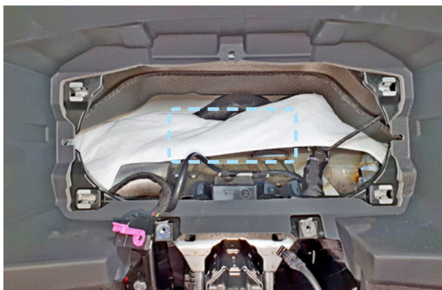
Фото 2.7. Пример расположения центрального блока охранно-телематического комплекса
