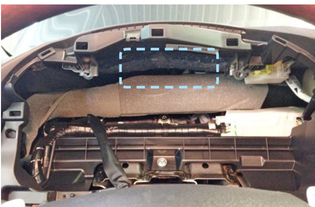
Фото 2.8. Пример расположения центрального блока охранно-телематического комплекса
