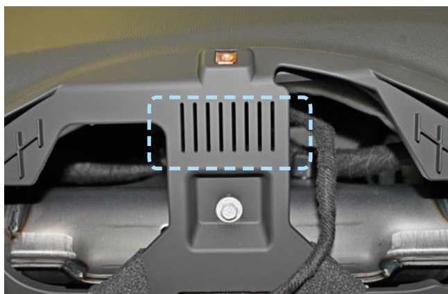
Фото 2.7. Пример расположения центрального блока охранно-телематического комплекса
