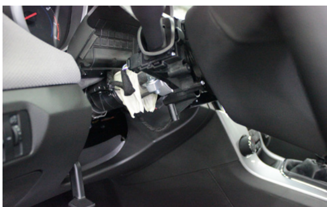
Фото 1.9. Нижняя часть кожуха рулевого вала снята
